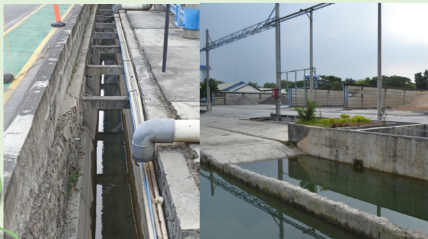
Instalasi pengelolaan air di tiap pabrik
