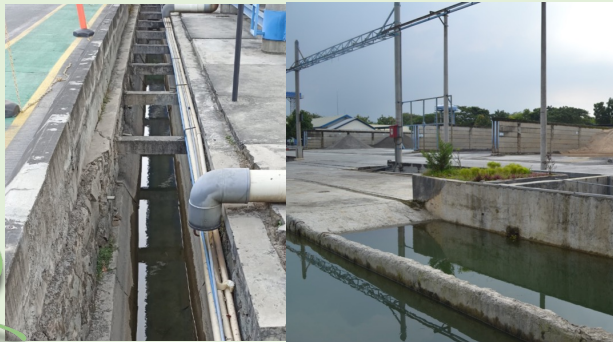
Instalasi pengelolaan air di tiap pabrik
